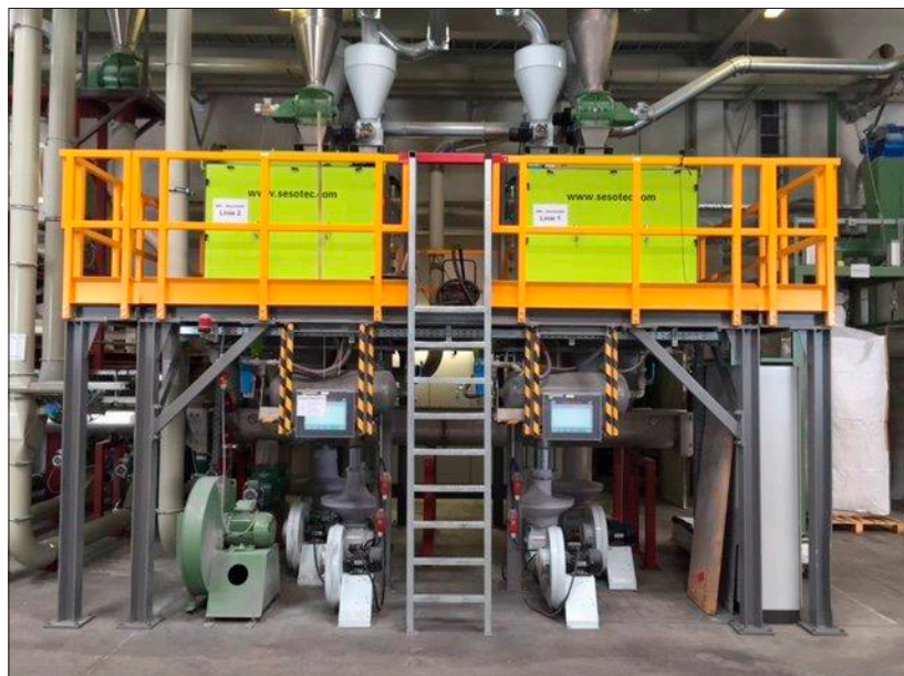
Bei der MultiPet GmbH in Bernburg werden zwei FLAKE PURIFIER Sortiersysteme von Sesotec zur farb- und sortenreinen Aufbereitung von PET Flakes eingesetzt.
